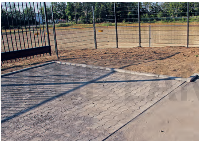
15. Einwirkung von Baustellenschmutz.
