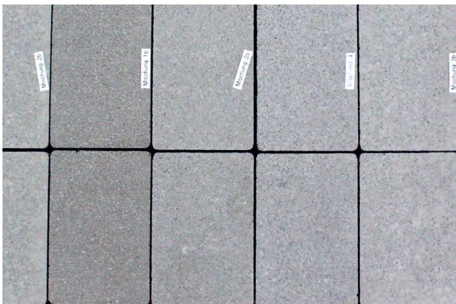
1. Farbschwankungen aufgrund unterschiedlicher Zementleimgehalte der Vorsatzbetone. Fotos: Voss
