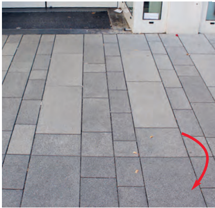
2. Farbschwankungen aufgrund von Unterschieden in der Abtragtiefe beim Strahlen.
