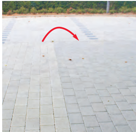
3. Farbunterschied zwischen unterschiedlichen Lieferchargen der Betonpflastersteine.
