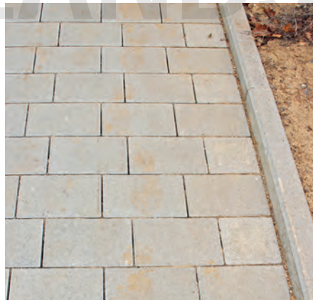
4. Verschmutzung einer Pflasterdecke durch anstehenden Boden.
