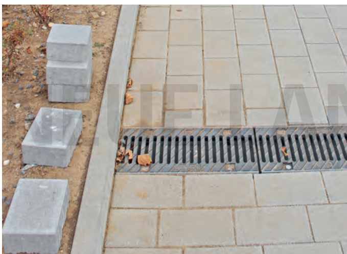
17. Beeinflussung des optischen Erscheinungsbildes durch die Verschmutzung einer Pflasterdecke.
