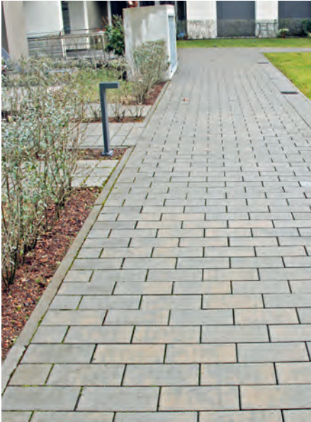
18. Durch die Verwendung eines Moosentferners verursachte braune Verfärbung einer Pflasterdecke.
