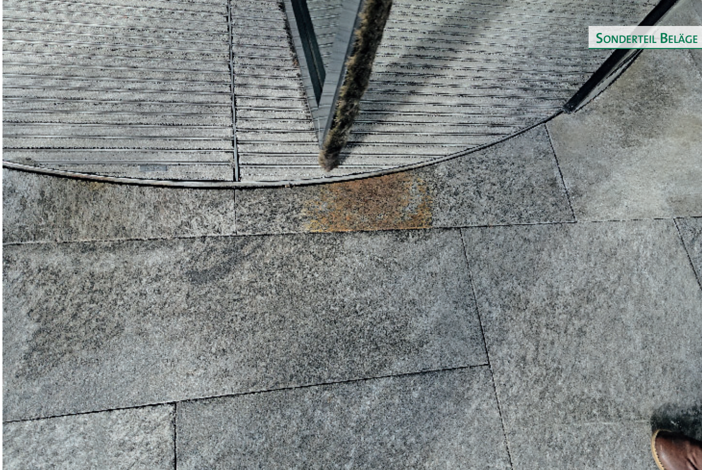
Serrizzo, Eintrag einer Rostlösung aus Metalleinbauteilen
