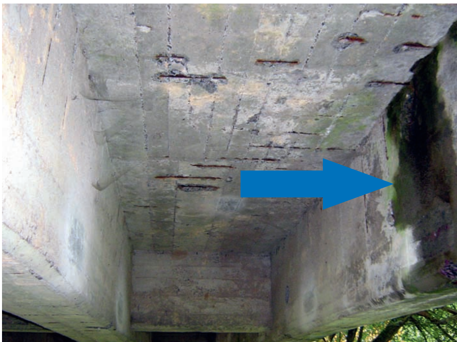
Bild 1: Zeitweise auftretende, ungeplante Feuchtezutritte
