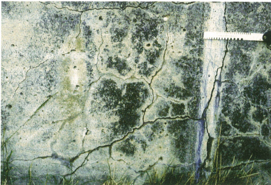
Abb. 9: Typisches Rissbild „Map cracking“ an einem AKR-geschädigten Beton aus [7]
