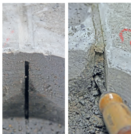
6. Nicht ausreichende Fugenfüllung.
